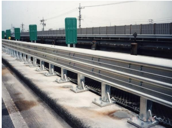
Защитные ограждения из балки с 3-волновым профилем
