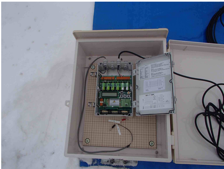
写真 2-2-2 機器検収 (データロガー)
