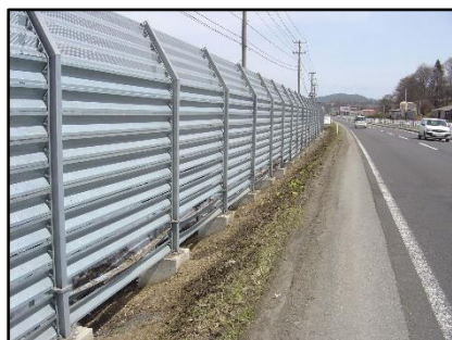
下部防雪板破損箇所へ
