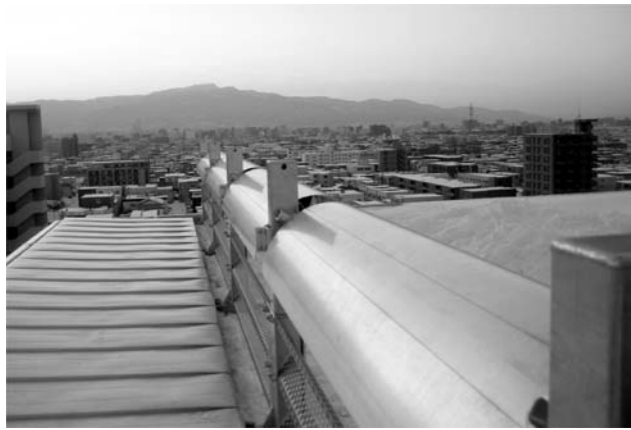
マンション屋上に設置された雪庇防止柵「スノーブレイド」
