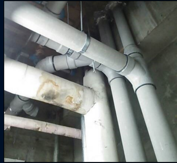
भवनहरूमा पानी आपूर्ति र ढल पाइपहरूको मर्मत र निरीक्षण वस्तु: PVC पाइप, स्टील पाइप
